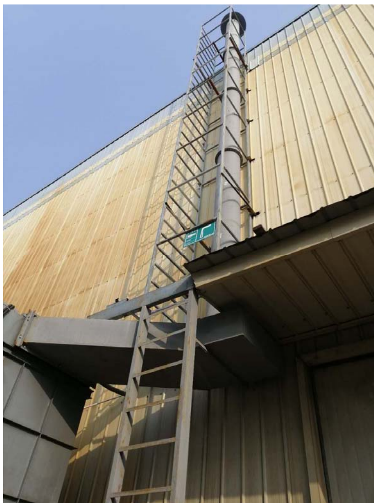
图 3-2 废气处理装置及排气筒
