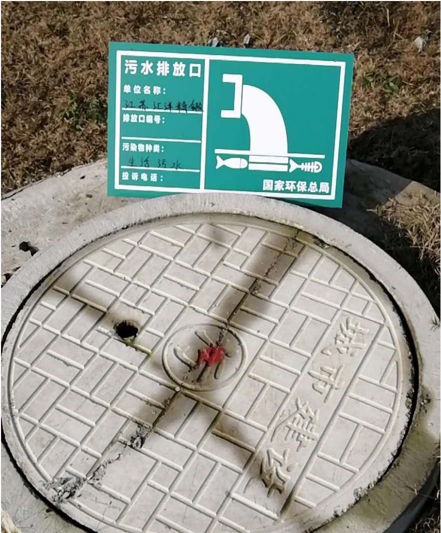
图 3-1 污水排口标识牌
